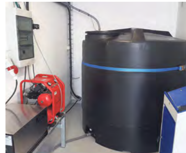
Spulevandet recirkulerer gennem en 3000 tons vandbeholder.
