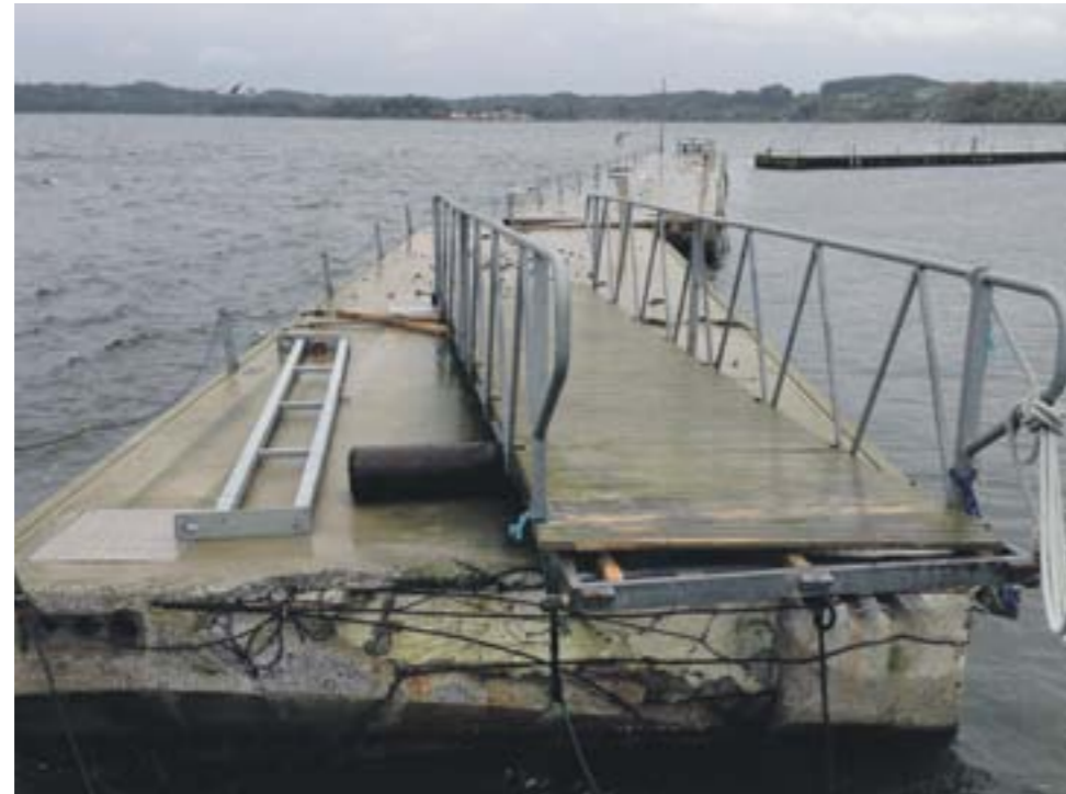
Et overbliksbillede af hele det svært skadede bølgebryder anlæg. Fotos: Sønderballe Lystbådehavn.
