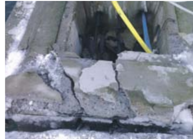
Stærkt beskadiget beton på flydebroerne. Fotos er fra 2013/14
