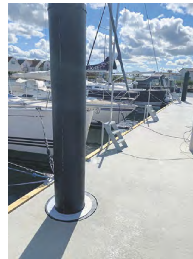
Indvendigt pælestyr er udført i beton med PVC foring og lukkes med en stålring.
