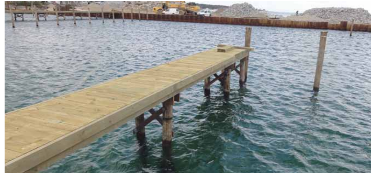
Bådebro med pæle i cloeziana, bjælker i azobé og dæk i fyrretræ
